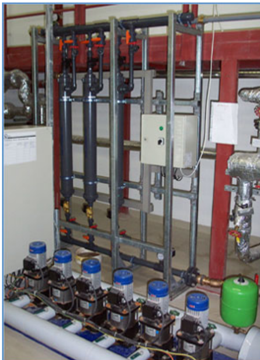
Legionellenfilter am Hauswasseranschluss
