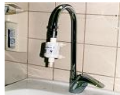
Am Auslauf montierter Legionellenfilter
